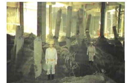
杭基礎の破壊
